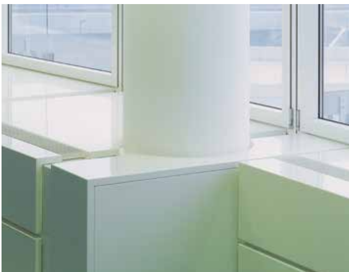
■ Andromeda-Tower Wien Quellluftgeräteverkleidung mit Lochblechfrontpanel für die Raumzuluft
